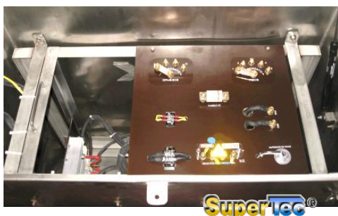
Vista superior rectificador refrigerado por aceite.
