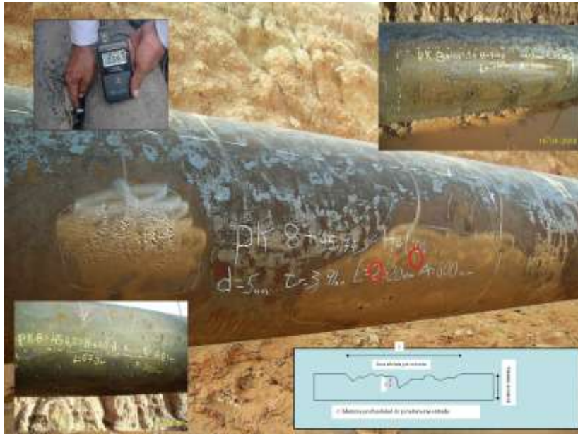
Evaluación directa de la corrosión externa (ECDA)
